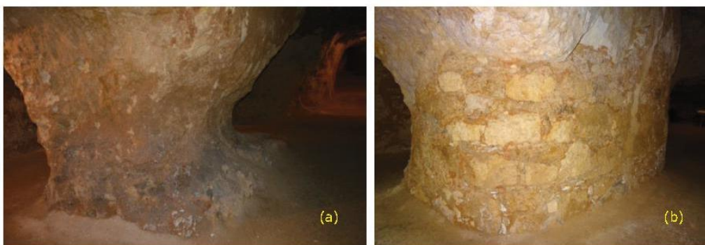
Figura 14 – Zona 4: (a) vista da base do pilar 15 com sobreescavação na sua parte inferior; (b) exemplo da proteção da base de um pilar com sobreescavação mediante o preenchimento das reentrâncias com pedra argamassada
