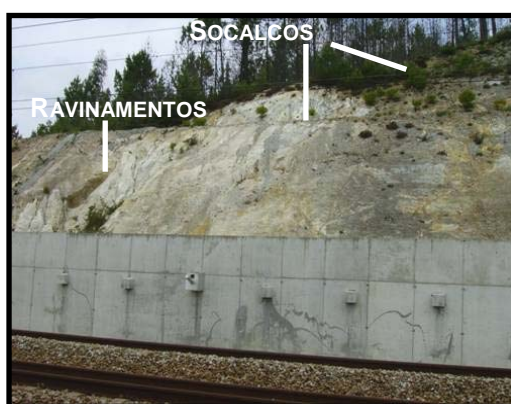
Figura 8 – Fotografia ilustrativa dos problemas geotécnicos ocorrentes no aplito caulinizado e as respectivas soluções adoptadas.
