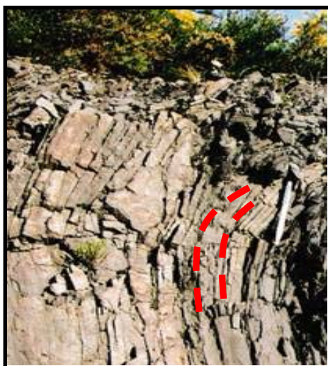
Figura 18 – Fotografia do afloramento onde é perceptível o fenómeno de “ creeping ”.
